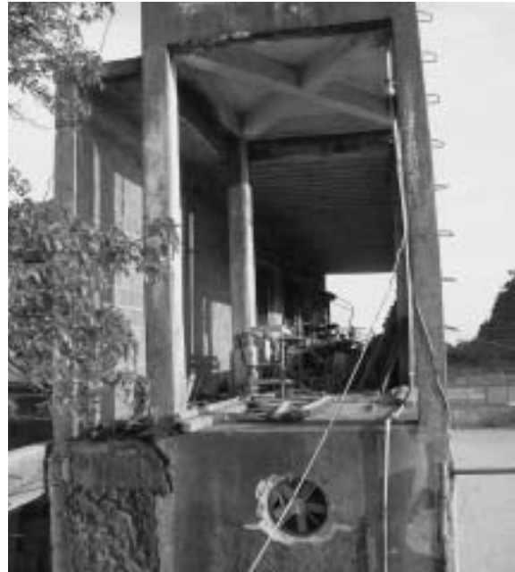
Der marode Wasserspeicher
